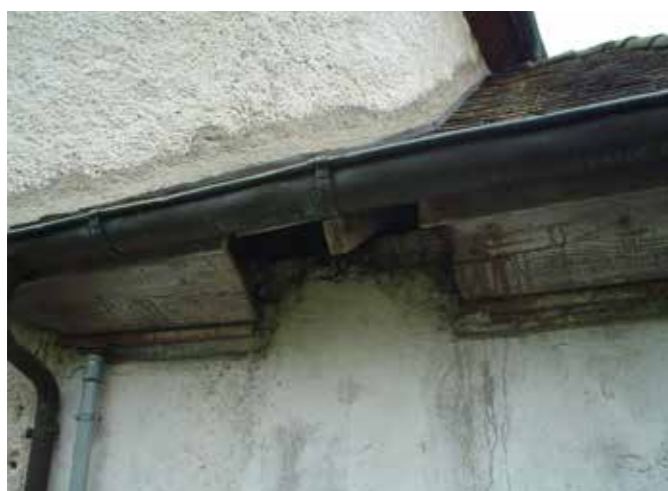
Das undichte Dach begünstigte das Eindringen von Feuchtigkeit.
