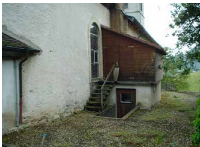
Das Fundament war nicht mehr sicher.
