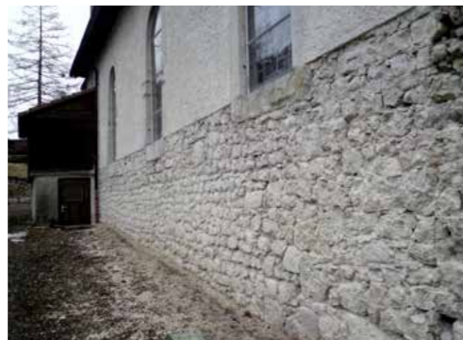
Die Mauern begannen zu bröckeln.
