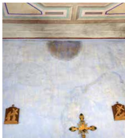
Du moisi et des décolorations foncés s'étendent sur les murs. L'odeur est désagréable. Les spores de moisissure sont éventuellement même toxiques.
