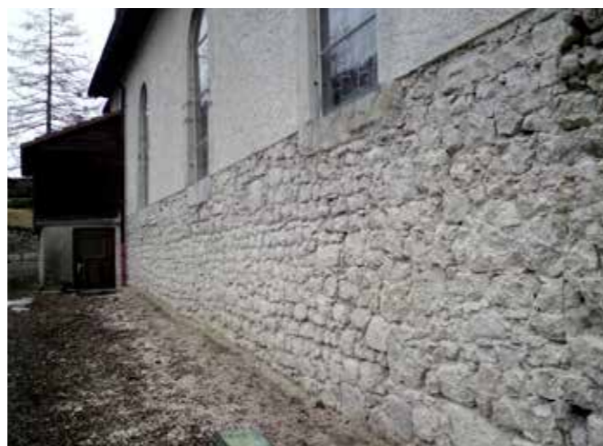
Les parois commencent à s'effriter.
