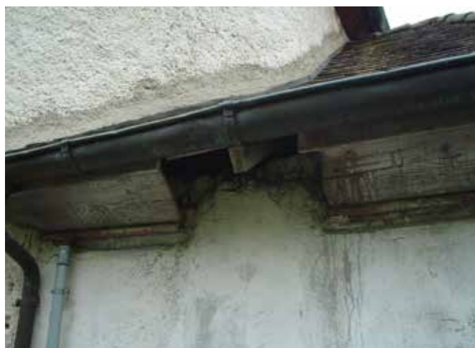
La toiture perméable favorisait l'intrusion d'humidité.
